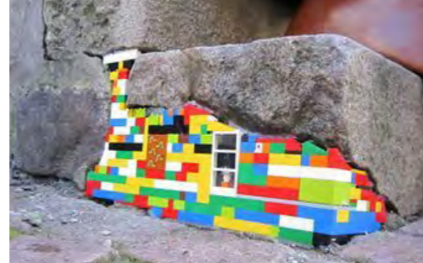
Forvitret trappe repareret med legoklodser
