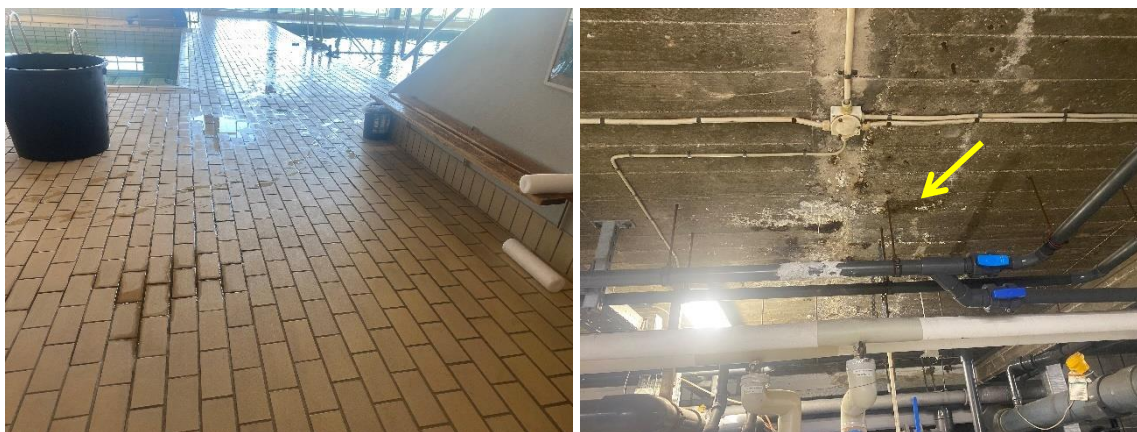
Figur 6-2: Område ud for kældertrappe og mellem det lille bassin og 25 m bassin. Lunger i overside samt punktvis "våde" områder i underside (pil).
