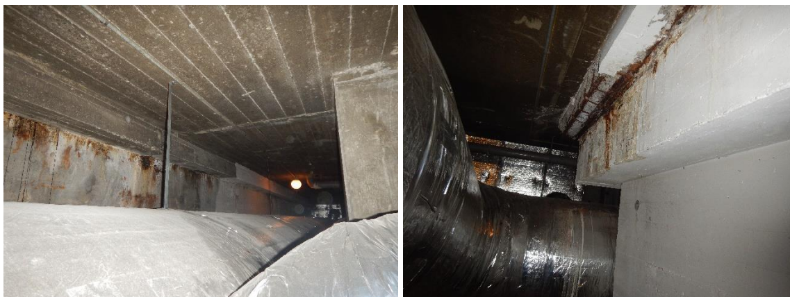
Figur 7-1: Fotos af rustudfældninger på skulperende med udspringspunkt i samlingen mellem vederlagsbjælke og skulperende. Billede til venstre viser springbassinets syd væg og billedet til højre bassinets nordvæg.
