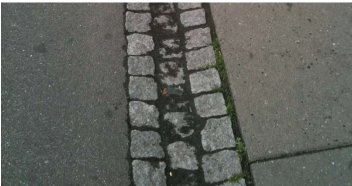
Ad 5.2 og 5.3 Stamvejen og boligvejens afgrænsning mod rabat eller mellem fortov og vej kan udføres med åbne vandrender af chaussésten, betonsten eller lign.
