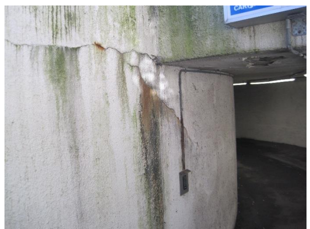
24. Ramper: Revne ved nedkørselsrampe (V).
