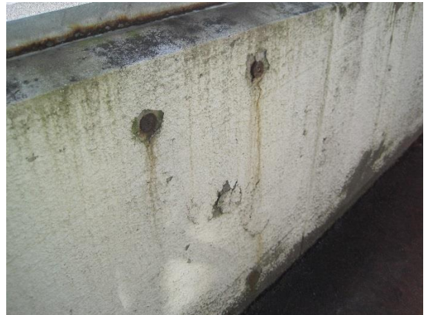
20. Ramper: Betonafskalninger fra jern fra støbeform (N).
