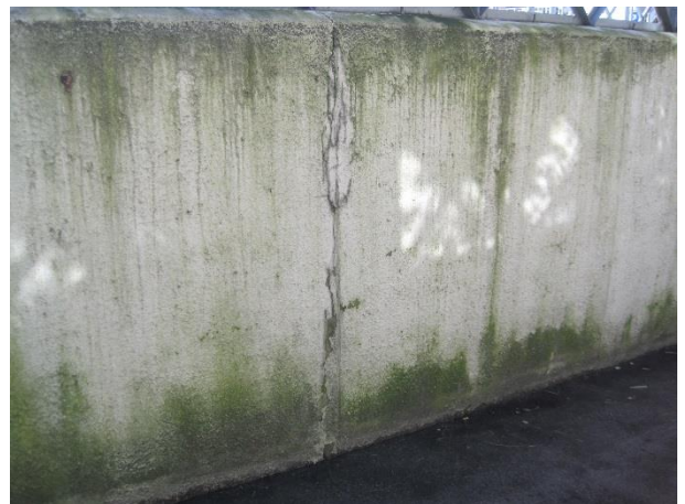
22. Ramper: Revne i rampevæg (S).
