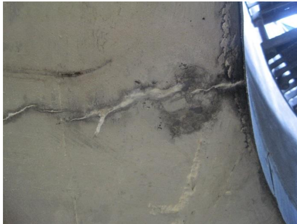
31. Trappenedgange S: Revner i loft ved trappenedgang i syd.
