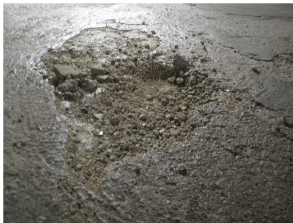
14. Kældergulv: Porøs beton fra kældergulvet (NV).
