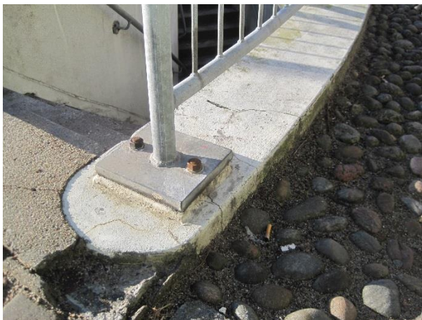
27. Trappenedgang N: Revnet overside af væg ved trappenedgang.
