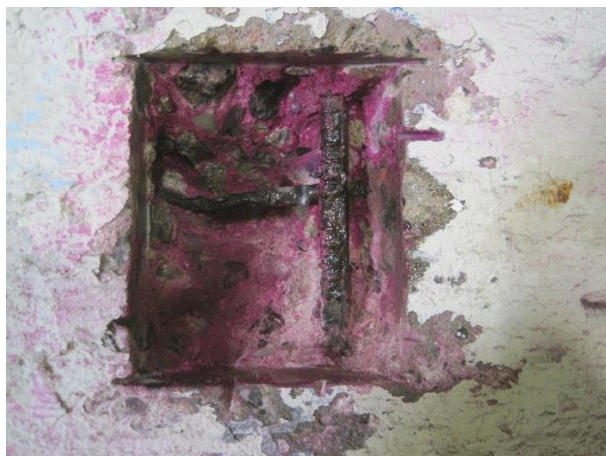
1. Behugning af væg: Stærkt korroderet armering (NØ).
