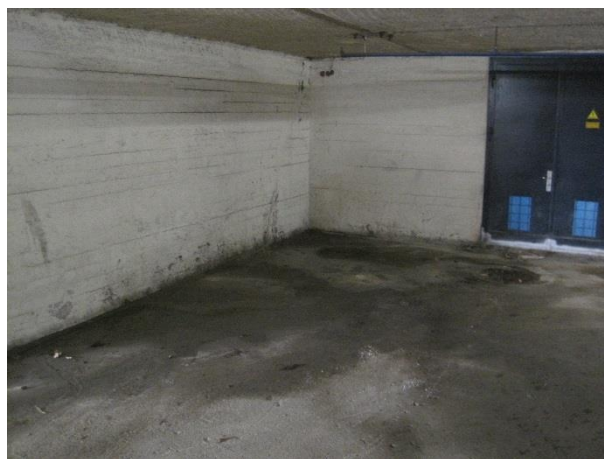
16. Kældergulv: Vådt kældergulv fra overfladevand og gennemsivninger gennem loft og væg (NØ).
