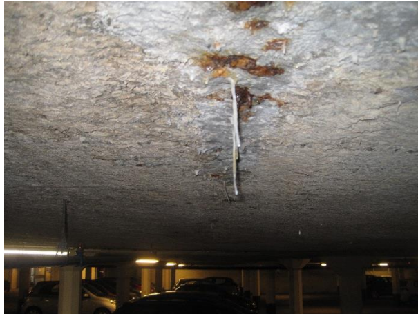
1. Underside af dæk: Gennemsvivninger i rette linjer.
