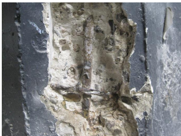
3. Behugning af søjle nr. 67: Porøs beton og stærkt korroderet armering.
