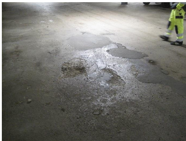
13. Kældergulv: Hullet kældergulv (NV).
