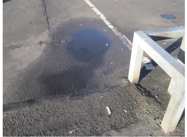
38. Belægning over dæk: Vandpytter på belægningen (N).
