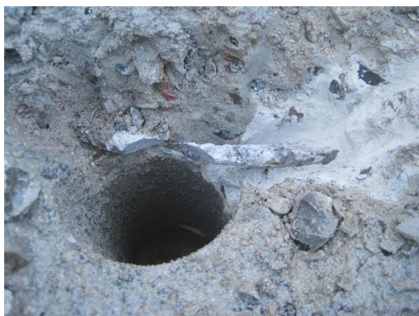
41. Belægning over dæk: Borekerne og behugning af dæk ned til spiralarmering (NØ).
