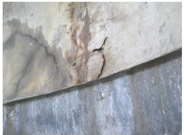
34. Trappenedgange S: Afskalning og rustudfældning ved trappenedgang.
