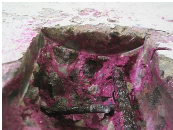
2. Behugning af væg: Stærkt korroderet armering (NØ).
