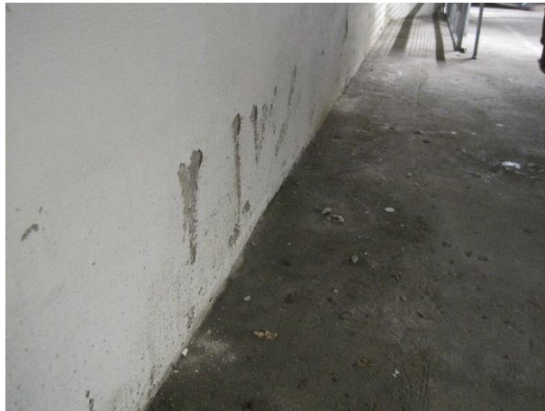
7. Kældervægge: Afskalninger på kældervæg (N).
