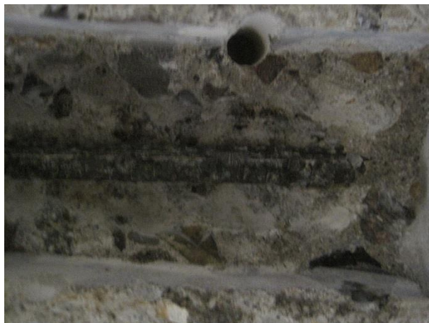
7. Behugning af loft (nr. 3): Begyndende overflade rust.
