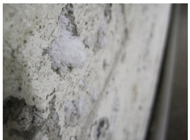
12. Kældervægge: Dannelse af saltkrystaller på kældervæg (NØ).
