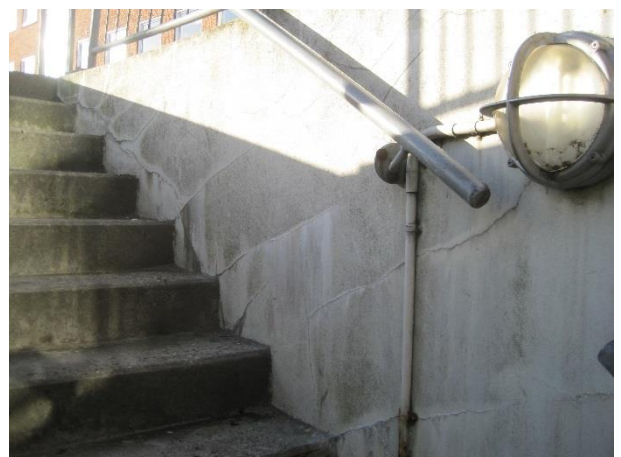
30. Trappenedgang N: Revner i væg ved trappenedgang.
