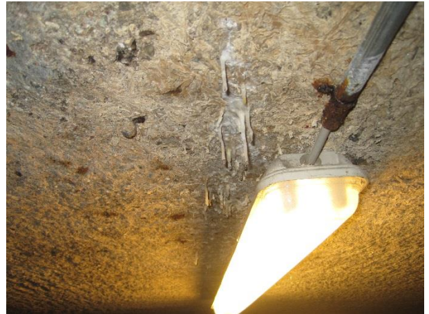
2. Underside af dæk: Gennemsvivninger i rette linjer.
