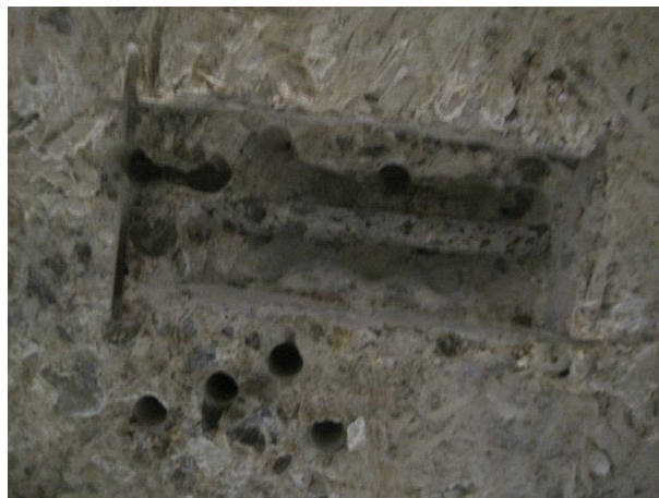
8. Behugning af loft (nr. 5): Begyndende overflade rust.
