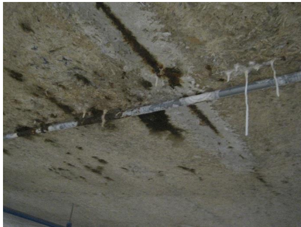
3. Underside af dæk: Blotlagt armering uden dæklag.
