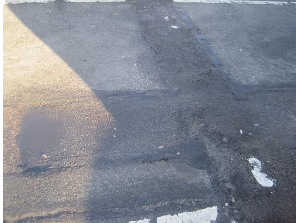
37. Belægning over dæk: Ujævn belægning og vandpytter efter asfaltarbejde (Midt).
