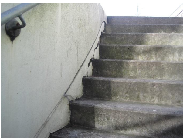
29. Trappenedgang N: Grove revner mellem væg og trappetrin.
