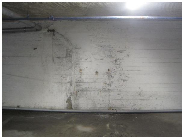
9. Kældervægge: Afskalninger på kældervæg og dannelse af saltkrystaller (NØ).
