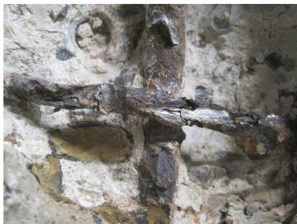
4. Behugning af søjle nr. 67: Stærkt korroderet armering i søjle.
