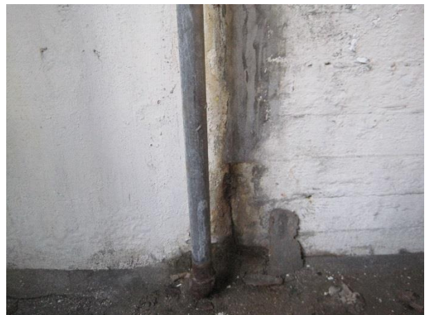
10. Kældervægge: Revner i kældervæg med gennemsivninger af vand (SV).
