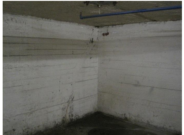
8. Kældervægge: Grove revner i kældervæg (NØ).
