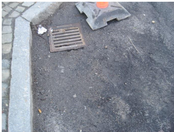
39. Belægning over dæk: Huller og porøs asfalt omkring afvandingsrist (NØ).
