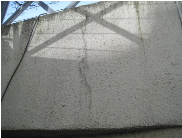
19. Ramper: Revner i vægge ved ramper (Ø).
