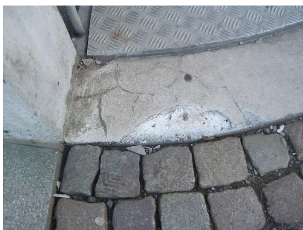
35. Trappenedgange S: Revner og afskalning på trin ved trappenedgang.
