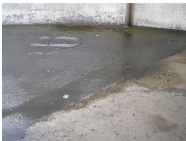
17. Kældergulv: Vand fra opkørselsrampe (NØ).
