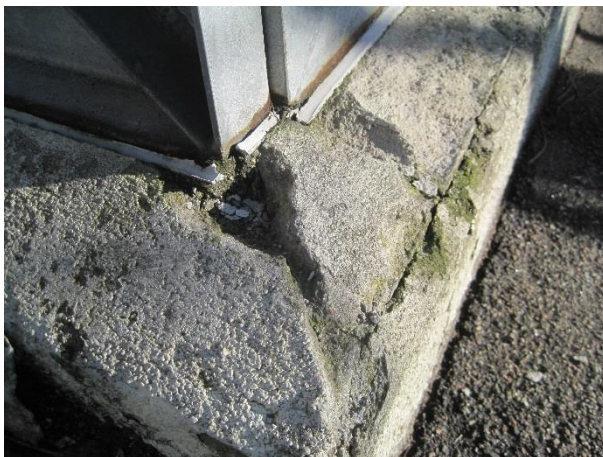
21. Ramper: Betonafskalninger i overside af rampevægge (V).
