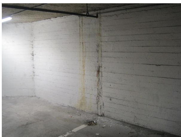
11. Kældervægge: Rustudfældninger fra samling mellem væg og dæk (SØ).
