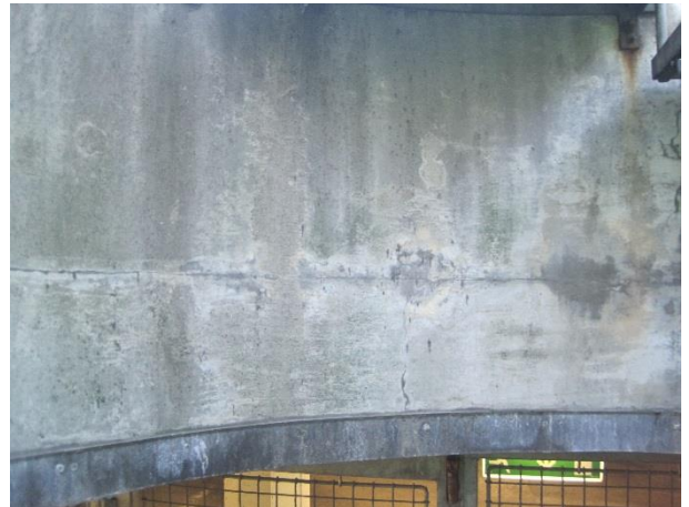
32. Trappenedgange S: Revner i væg ved trappenedgang.
