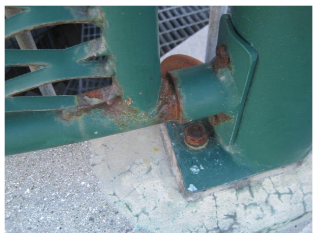
36. Trappenedgange S: Netrevner i væg ved rækværk og stærkt rustet rækværk.
