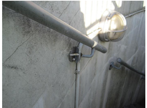
26. Trappenedgang N: Håndliste efter påkørsel.
