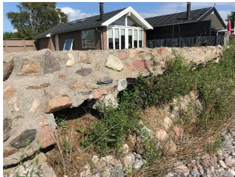
2. Nærbillede af skadet mur.
