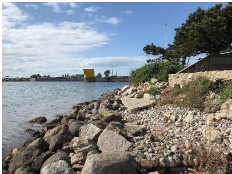
1. Stenkastning med skadet væg nordligste del.
