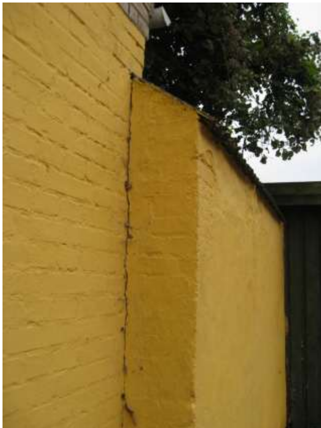
Hegnsmur i skel er løsnet, nabogrund
