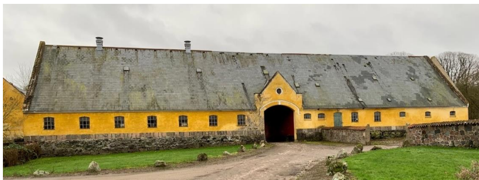
Gårdens drift-/staldlænge med central port. Ejer ønsker denne bygning fjernet.
