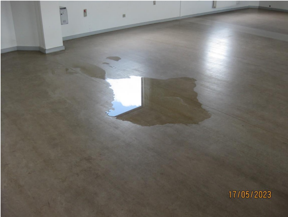
SIFFEN: Vand på gulvet pga. utæt tag
