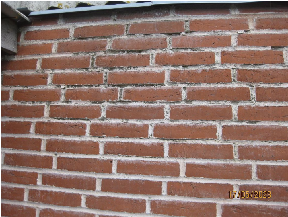
Partielt dårlige mørtelfuger
