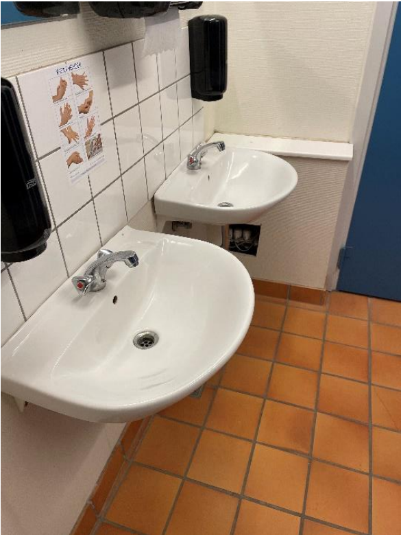
Blandingsbatterier bør udskiftes til berøringsfri armaturer (energibesparelse)
