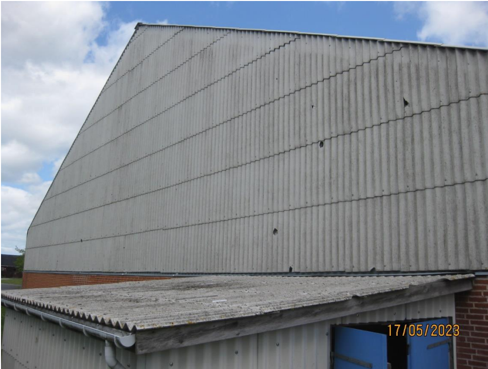
Gavlbeklædning med partielle huller
