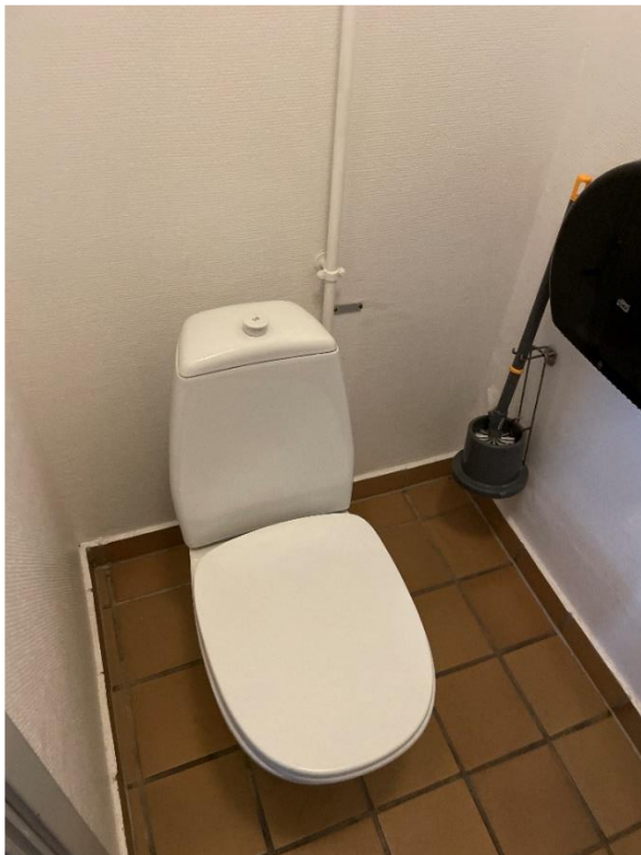
Toiletter bør udskiftes til vandbesparende 2 skylds
