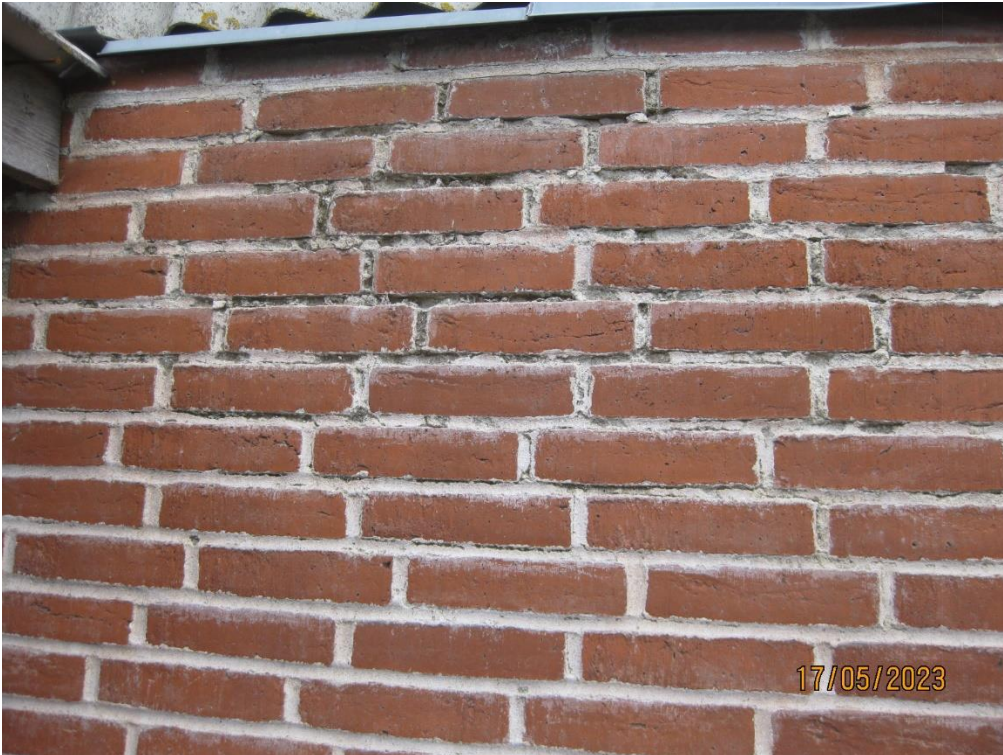
Partielt dårlige mørtelfuger
