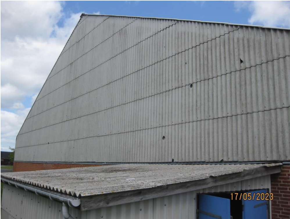
Gavlbeklædning med partielle huller
