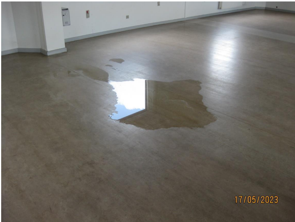
SIFFEN: Vand på gulvet pga. utæt tag
