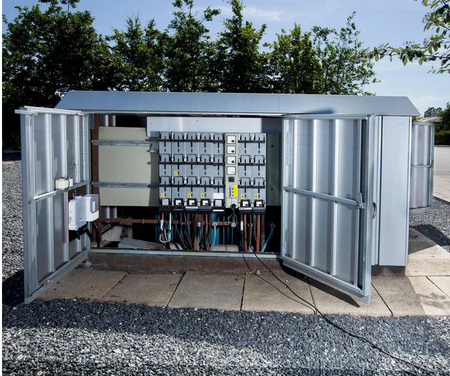
Figur 9 Eksempel på yderligere installationer i et solcelleanlæg
