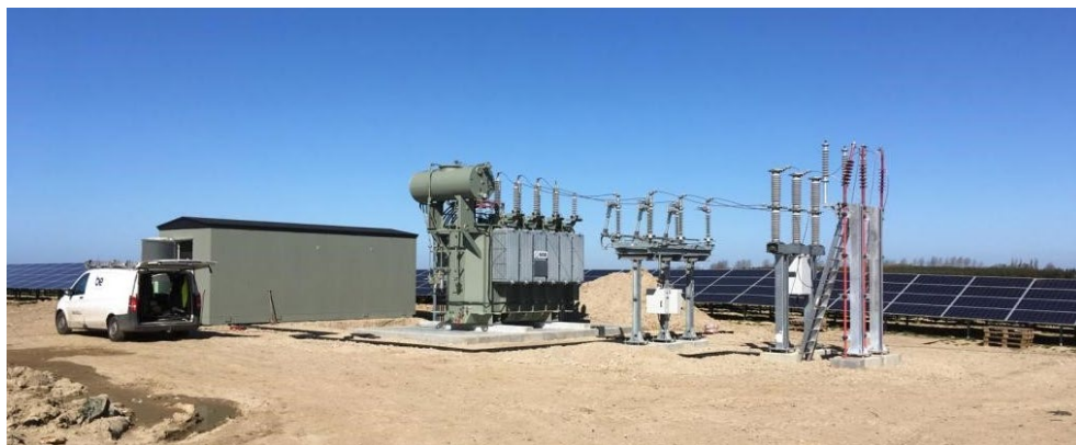
Figur 1-6 Eksempel på stepup-transformer og en teknikbygning.
