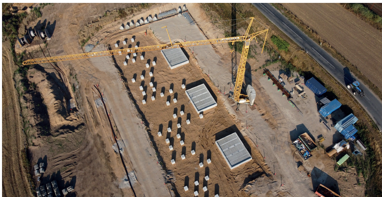
Behov for el vil stige markant. Bygning af transformatorstation ved Hejninge vest for Slagelse.
