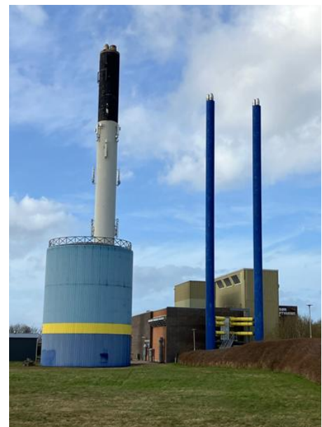
Varmecentral til reservelast i Korsør.
