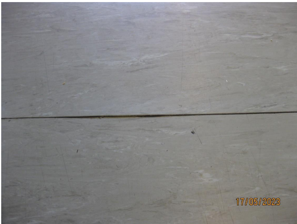
Slidt linoleum og defekt svejsning i køkken
