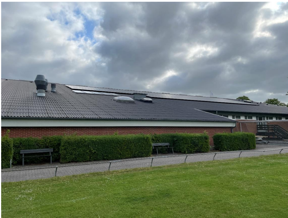
Hallens bølgeeternittag, hvor tagplader revner
