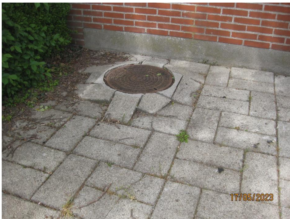
Kraftig sænkning ud for kantine, og problem med tilstopning
