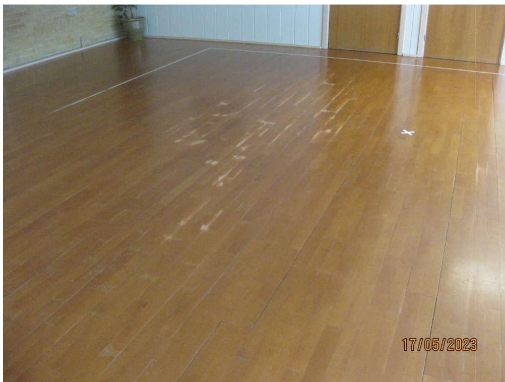
Vandskadedt gulv i Multirum på 1. sal
