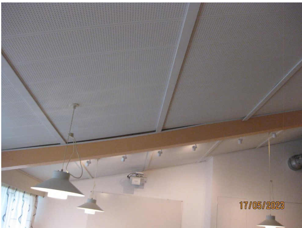
Ældre akustikloft med løse lister i cafeen
